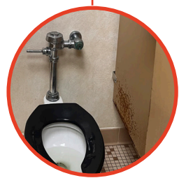
Metal Toilet Partitions
